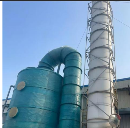
大密充电北废气排气筒 (DA023)
