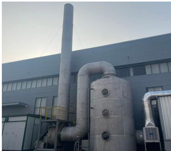
五期充电北废气排气筒 (DA028)
