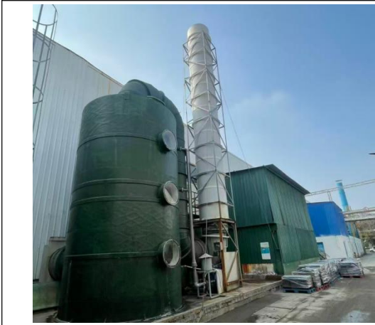
四期化成北废气排气筒 (DA018)
