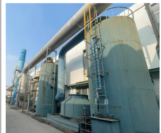
摩托车组装北、铅零件、四期辊剪北废气排气筒 (DA010)
