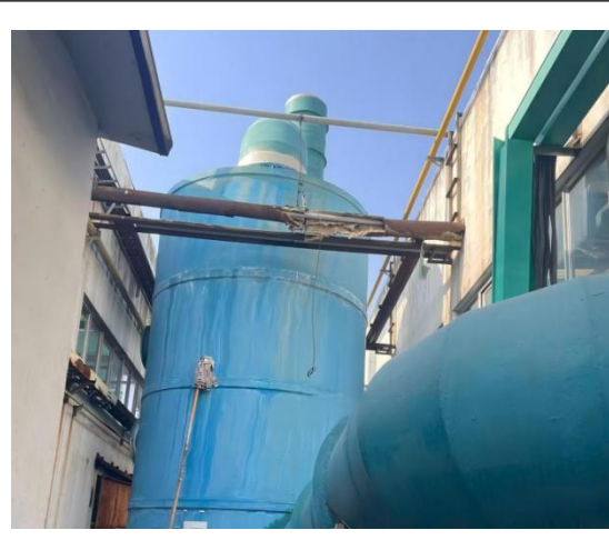
一期化成南废气排气筒 (DA017)
