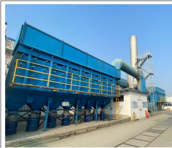
大密组装废气排气筒 (DA012)
