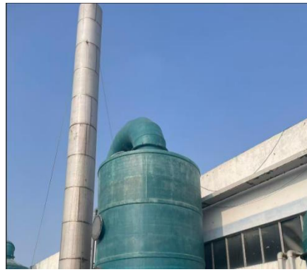
小密充电中废气排气筒 (DA021)
