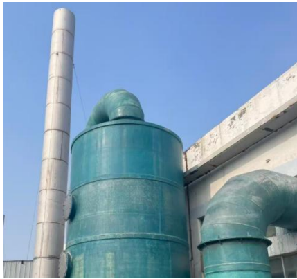
小密充电东废气排气筒 (DA022)
