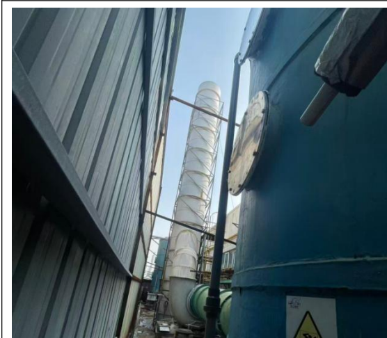
一期化成北废气排气筒 (DA016)
