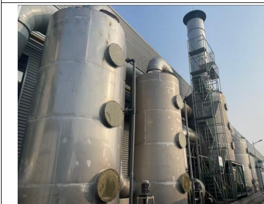
五期铅粉、和膏废气排气筒 (DA014)
