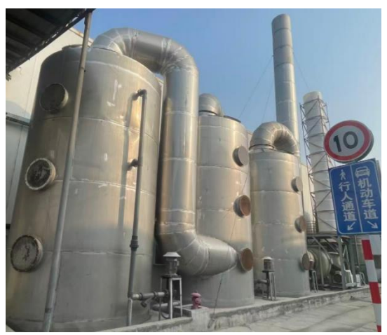
四期铸板西、南废气排气筒 (DA009)
