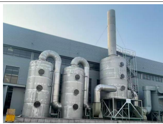
五期组装废气排气筒 (DA015)
