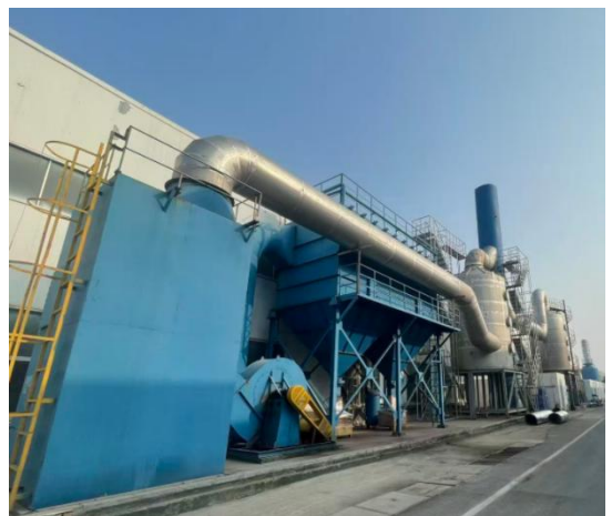
摩托车组装南、四期干燥、辊剪南废气排气筒 (DA011)
