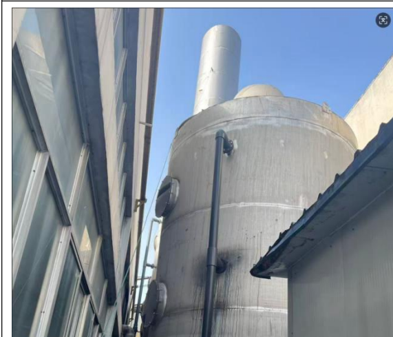
一期铅粉、和膏废气排气筒（DA002）
