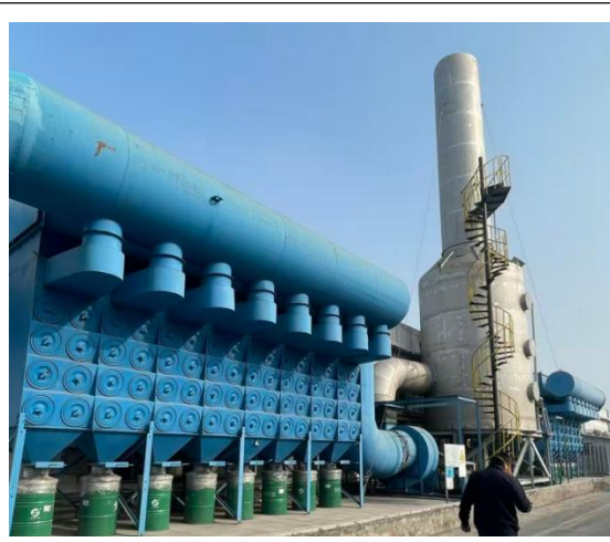
小密组装西、东废气排气筒 (DA007)
