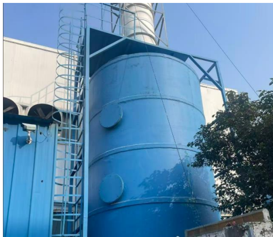
摩托车充电废气排气筒 (DA026)
