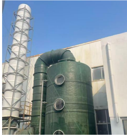
四期化成南废气排气筒 (DA019)
