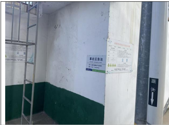
事故池（位于污水站）（容积240m 3 ）
