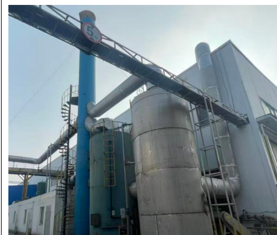
四期和膏、铅粉废气排气筒 (DA008)
